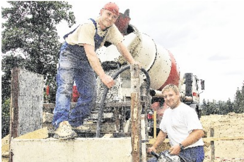
Am Skilift in Rugiswalde haben jetzt die Bauarbeiten begonnen. Uwe Schaffrath (links) und Torsten Kraus verfestigen den Beton im ersten von sechs Fundamentpfeilern des neuen Skiliftes. Der neue Lift wird 460 Meter lang und damit 150 Meter länger als der alte sein und mit 1200 Personen pro Stunde doppelt so viele Sportler befördern können. Die Einweihung soll voraussichtlich am 11./12. Oktober sein. Foto: Frank Baldauf
