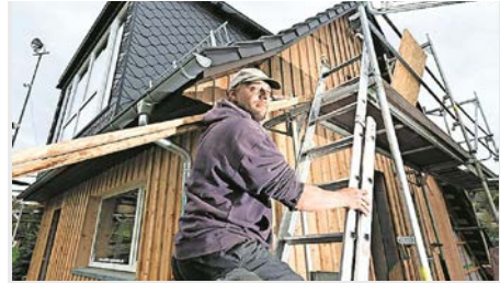
Maik Schübel vom Dachdeckerbetrieb Schlenker bringt Holzlatten an der Fassade der Lifthütte in Rugiswalde an. Als Mitglied des ortsansässigen Skiclubs ist die Sanierung für ihn wahrlich eine Herzensangelegenheit. Foto: Steffen Unger
